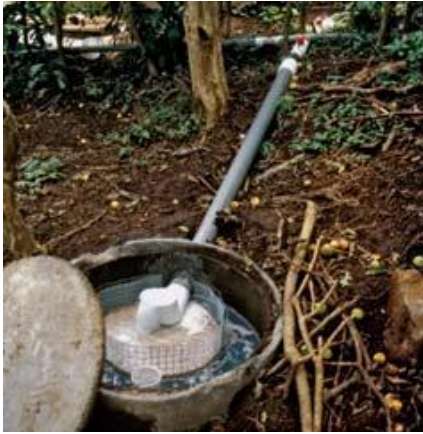
شكل (4) خزان الترسيب يحتوي على شبكة فولاذية لتسهيل عملية التنظيف
