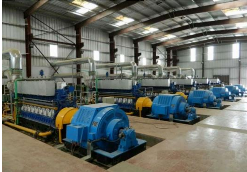
شكل ٣-١ نظرة عامة على محطة ديزل لتوليد الكهرباء
